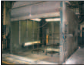
BCP Blast Booth
