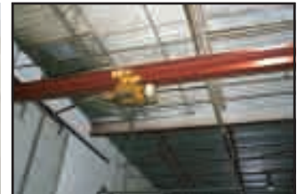
1 Ton Overhead Hoist
