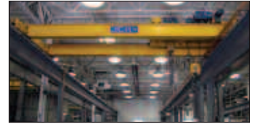
MT.CLEMENS 7.5 TON & 3.5 TON CRANE CELL
